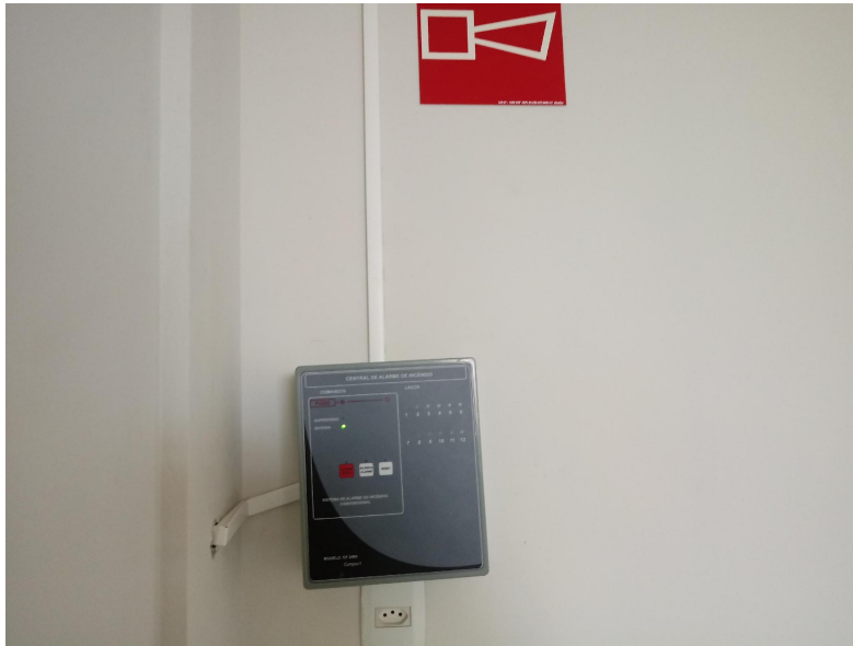
Foto: equipamentos de incêndio – central de alarme.
