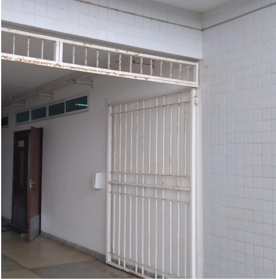
Foto: Grade em ferro com manchas de ferrugem devido à ausência de realização de manutenção preventiva
