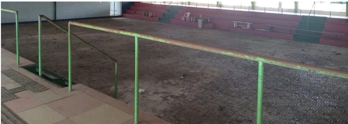
Foto: guarda-corpo sem manutenção periódica
