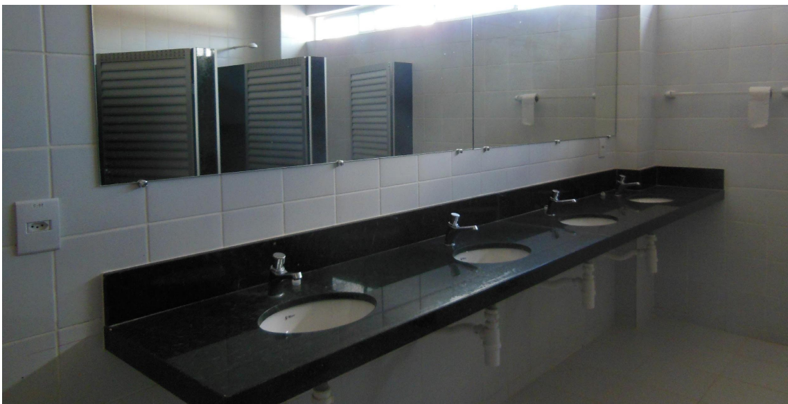
Fotos: bancadas de granito em banheiros
