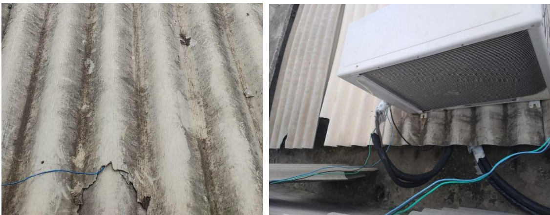
Fotos: danos no telhado, após instalação de aparelhos de ar-condicionado.
