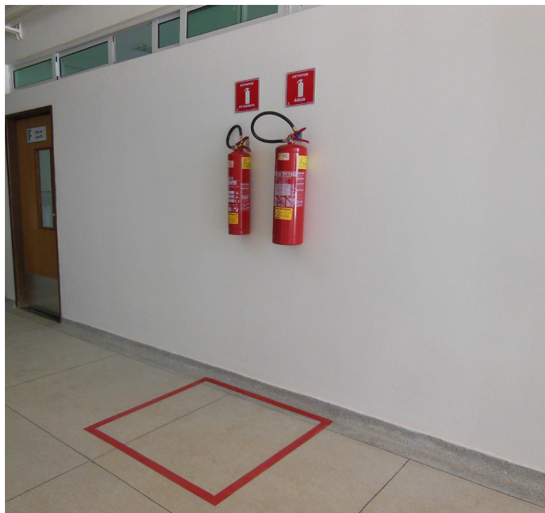
Foto: equipamentos de incêndio – Extintores.
