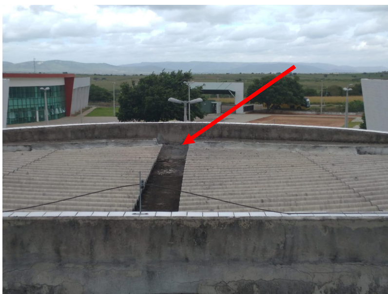
Foto: calha de concreto localizada na cobertura do campus que capta as águas da chuva encaminhadas pelas telhas.
