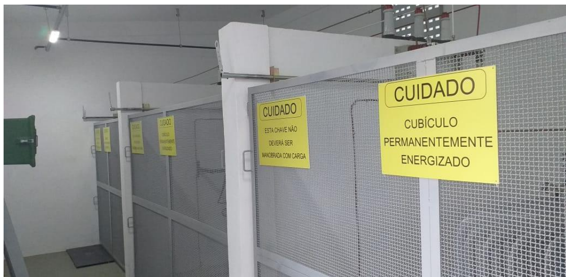
Foto: parte interna do abrigo com os equipamentos da subestação
