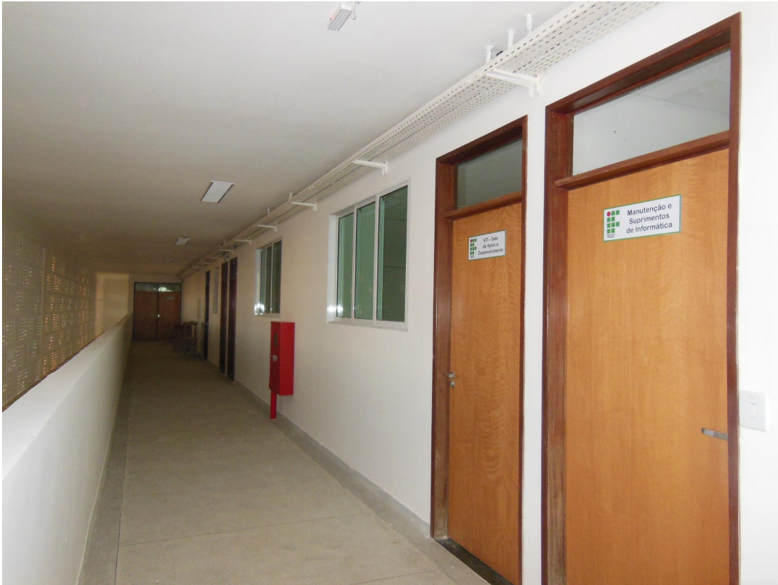
Foto: piso em granilite
