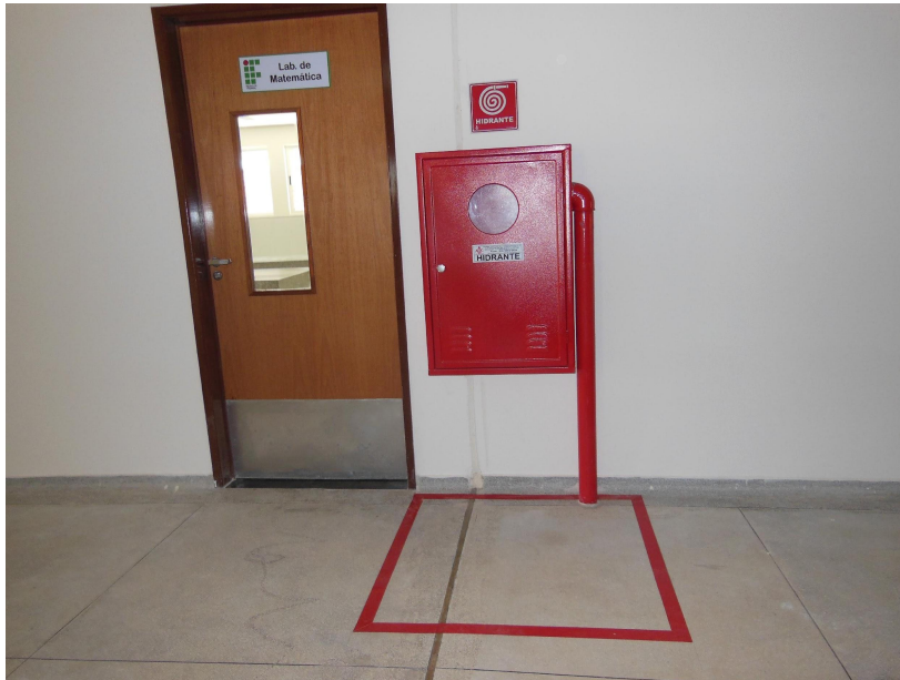
Foto: equipamentos de incêndio – Hidrantes.
