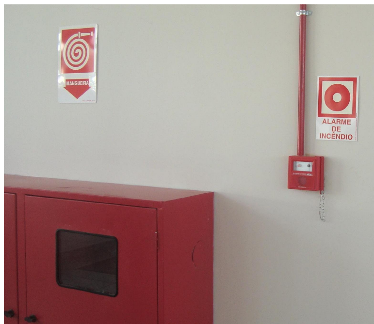
Foto: equipamentos de incêndio – Alarme.
