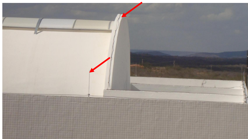
Foto: Haste e cordoalha, elementos do sistema de SPDA.
