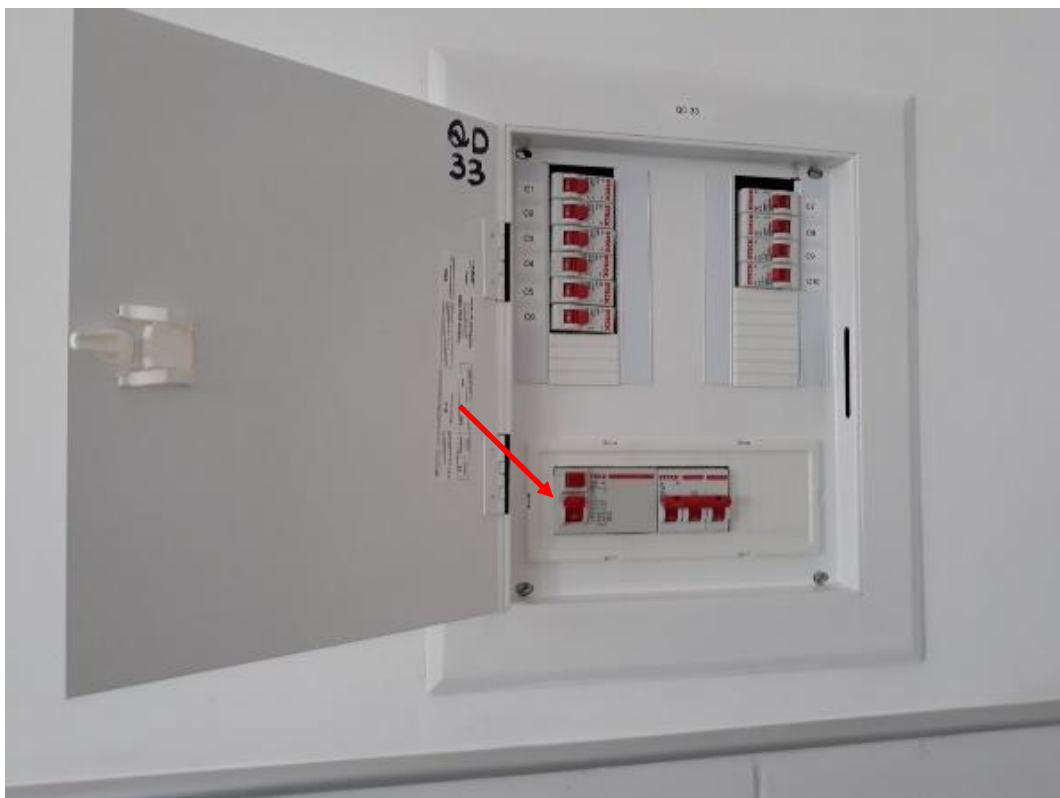
Foto: quadro de distribuição de circuitos com DR.
