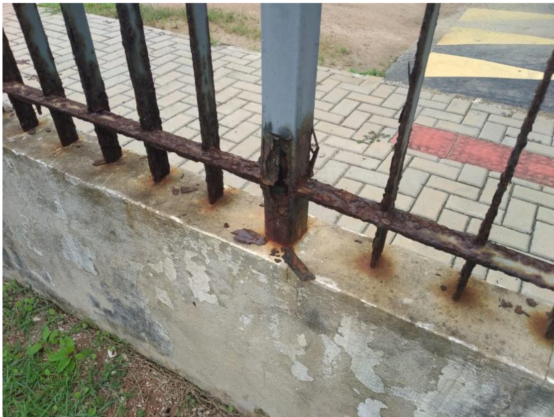
Foto: Grade em metalon deteriorada devido à ausência de manutenção preventiva
