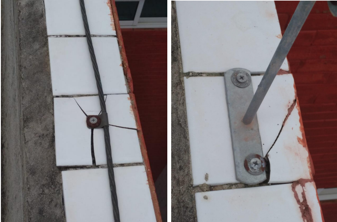
Foto: fixação do sistema de SPDA que danificou o revestimento e a impermeabilização, causando vazamentos na edificação.
