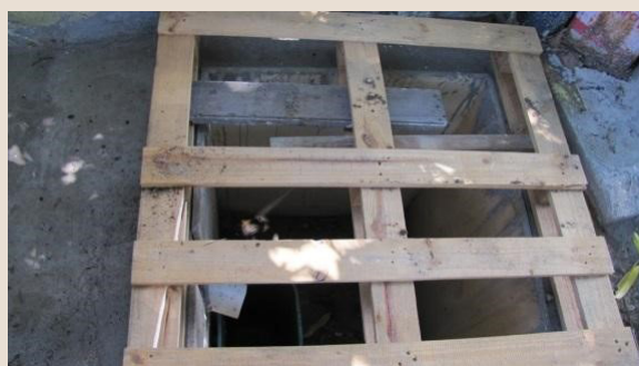
FIGURA 39 – Detalhe da proteção do poço destinado à coleta do chorume Fonte: ANDRADE, Laura (2016).
