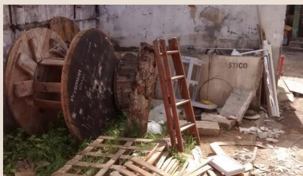
FIGURA 12 – Estrutura deteriorada das Baías Fonte: ANDRADE, Laura (2016)
