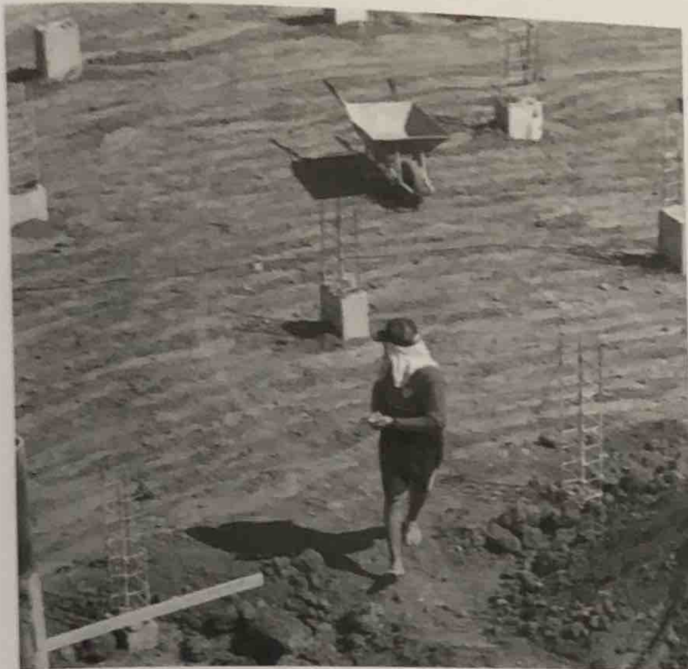
Figura 3 – Trabalhador transitando em canteiro sem o uso de botas, capacete e uniforme.
