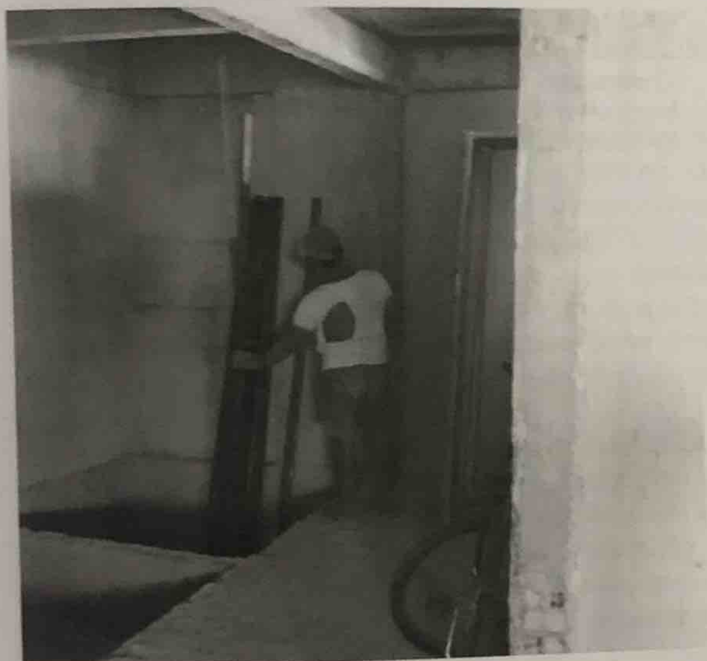
Figura 4 – Trabalhador em área de risco de queda sem EPI's e EPC's adequados.
