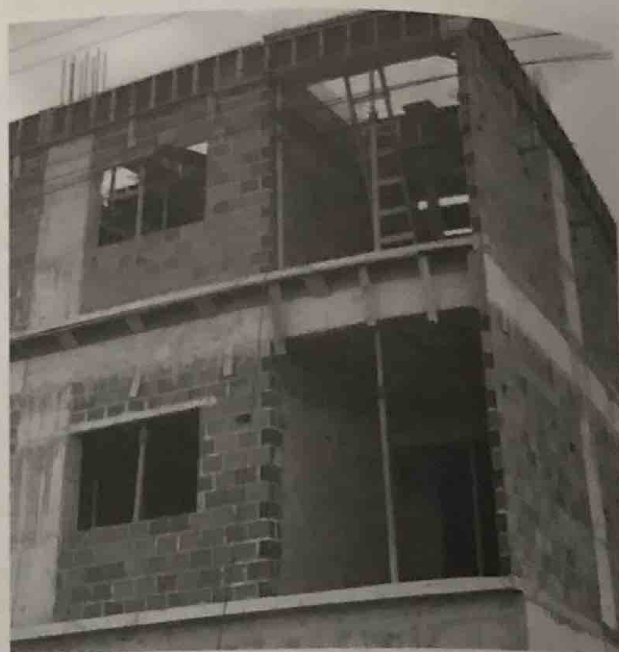
Figura 1 - Periferias de edificação sem proteção contra quedas e escada móvel sem apoio e travamento.
